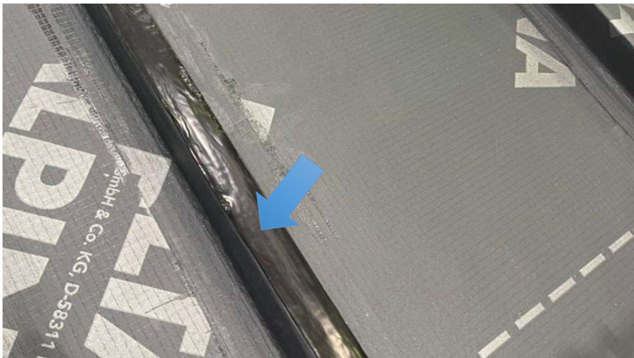
Рис. 11 Нижняя кровля из DELTA-ALPINA, контробрешётка интегрирована в слой гидроизоляции Klasse 1. Уплотнительная лента DELTA-DICHT BAND поверх контробрешётки и гидроизоляции, полная защита от протечек даже через места крепления разреженного настила
